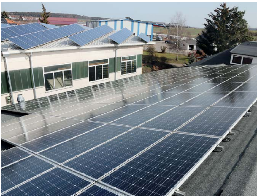
Die 52-kWp-PVA auf den Dächern der Metzgerei Eisele ist ans Netz angebunden.
