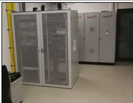
Bild 3: Der Blick in den Technikraum auf den IT-Schrank und den Stromspeicher Pacadu Flex
