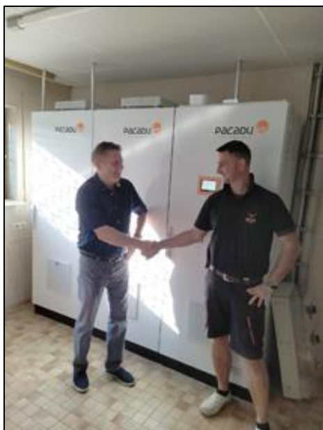
Bild 3: Jürgen K. Heller, Leiter Vertrieb & Marketing bei ASD (li) und Thomas Eisele (re) kennen sich gut: Aufgrund der Zufriedenheit mit dem bisherigen Stromspeicher war klar, dass bei der nächsten Ausbaustufe wieder ein Pacadu zum Einsatz kommen soll.
