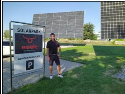
Bild 2: Das Energiesystem der Metzgerei Eisele besteht aktuell aus drei Photovoltaik-Anlagen mit insgesamt 115 kWp, einem Blockheizkraftwerk, einem E-Auto samt mehrerer, auch öffentlich zugänglicher Ladesäulen und zwei Speichern mit Pacadu-Technologie.
