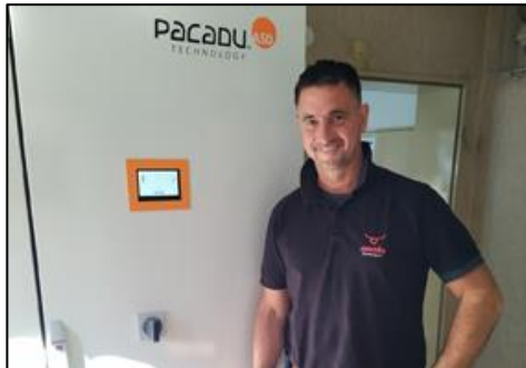
Bild 1: Thomas Eisele gehört zu den Vorreitern im Umgang mit erneuerbaren Energien und Stromspeichern: Schon 2015 hatte der Metzgermeister ein System aufgesetzt und installiert, das einen Pacadu-gesteuerten Stromspeicher umfasste.
