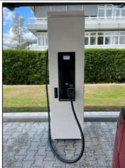
Bild 4: ... und – wenn es schnell gehen soll – an einer DC-Schnelladesäule mit bis zu 50 kW.
