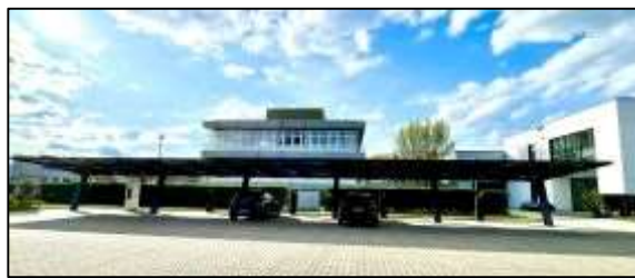
Bild 2: Der Solarcarport von 1st Flow Energy Solutions ermöglicht es, den PV-Strom vor Ort zu verwenden – und das direkt oder zu einem späteren Zeitpunkt.
